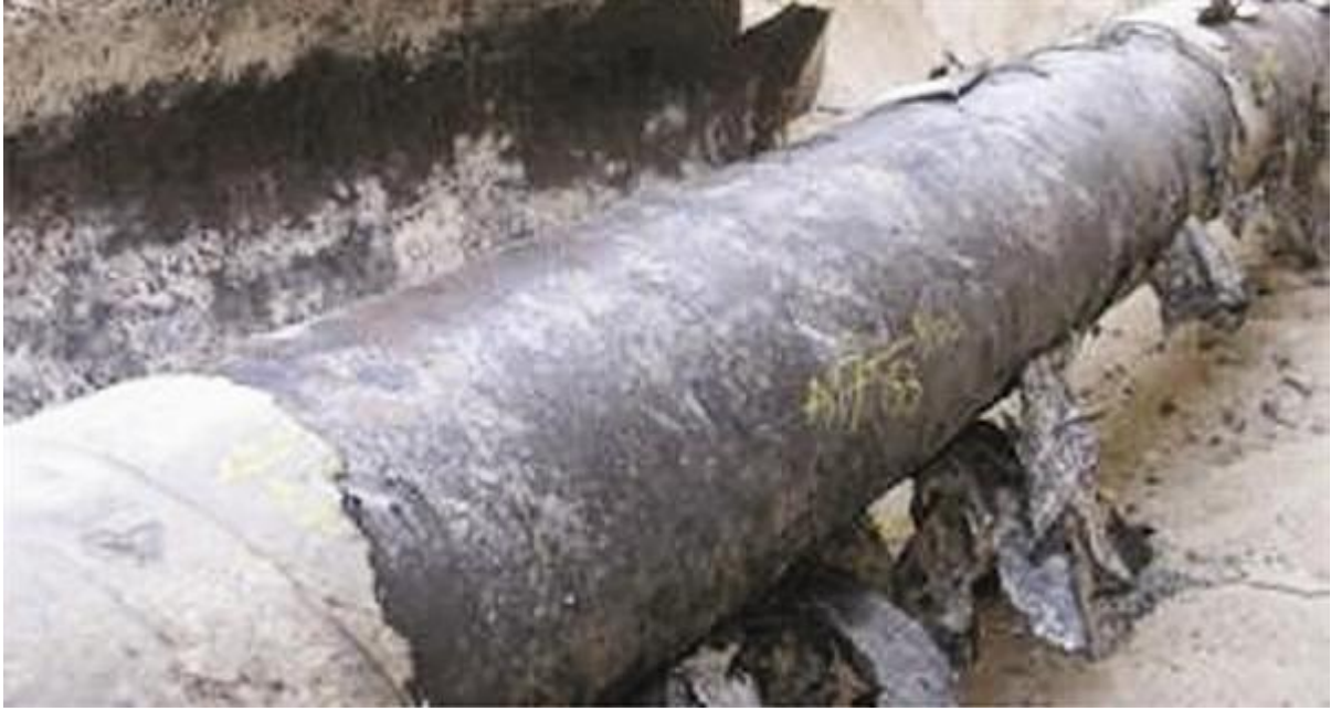
انبوب متآكل لنقل النفط الخام
